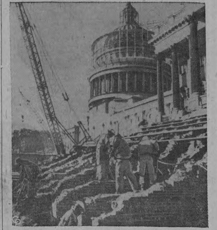
HACIENDO ARREGLOS. — Varios trabajadores rompen los peldaños de la Ala del Senado del Capitolio de Washington para hacer una vía en los trabajos de excavación y construcción para una terminal de trenes subterráneos. Más tarde, los peldaños de mármol serán reconstruidos en granito.
